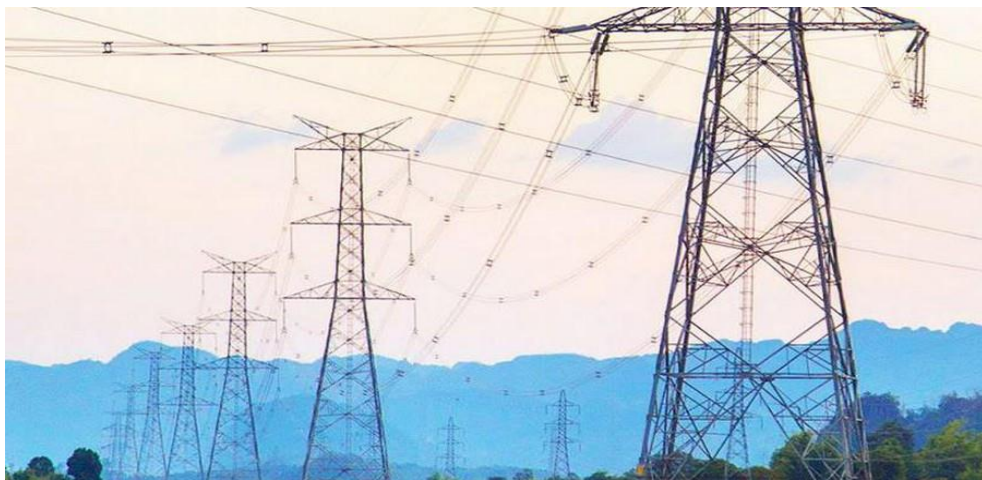
Hình 3.9: Lưới dây điện tại điện thủy NamNguam (Lào)
